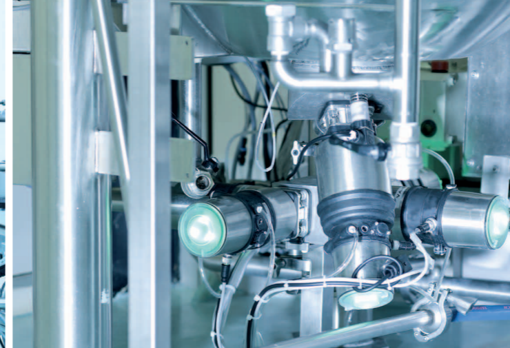
Ensemble de vannes sur une cuve de transfert.
